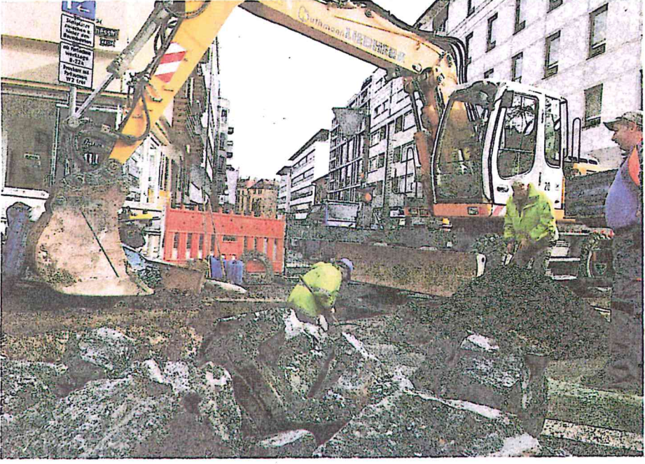
Telekommunikationsunternehmen können das Mitnutzen öffentlicher Versorgungsnetze verlangen. FOTO: DPA
